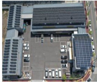
울주 공장지붕 (200kW)
