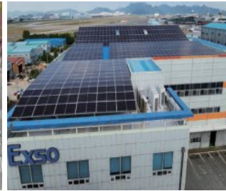
유통단지 곡선형 지붕(200kW)
